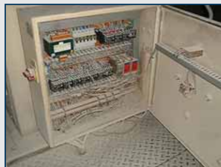
Ook een IP 65-schakelkast is niet stofdicht met een open deur!
